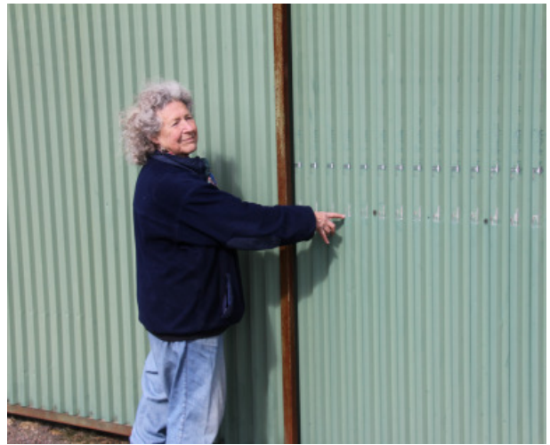
.....för då blir det fula skador i plåten..
